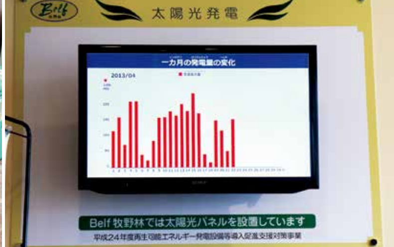
店内にもモニターを設置し発電状況をお知らせしています。
