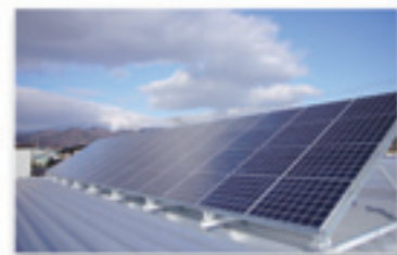
太陽光発電パネルが屋上に設置されています。
